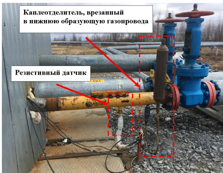
Рисунок 72 – Общий вид врезки оборудования при испытаниях с закачкой солевых растворов на скважине № 814
